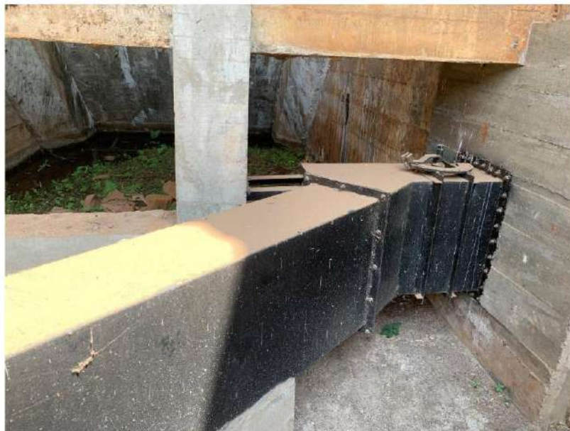
Foto 5 – Tubulação de descarga da vazão sanitária.
