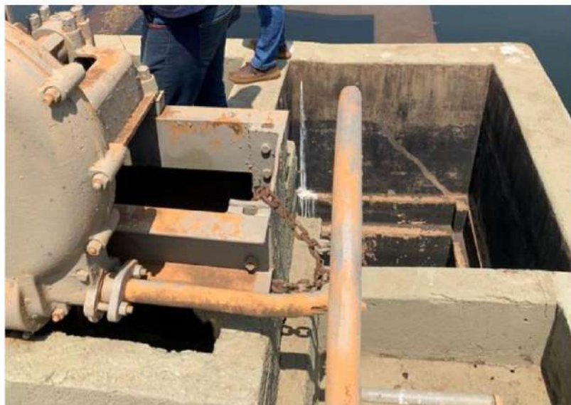
Foto 9 – Mecanismo de acionamento da comporta da Tomada d'Água.
