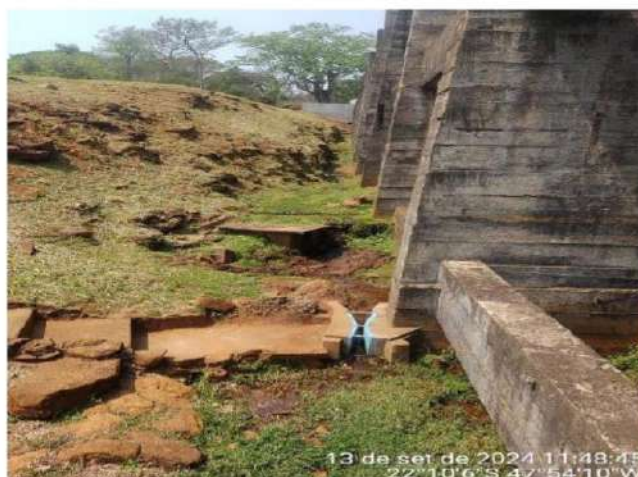
Foto 6 – Calha Parshall de 2" na margem direita.
