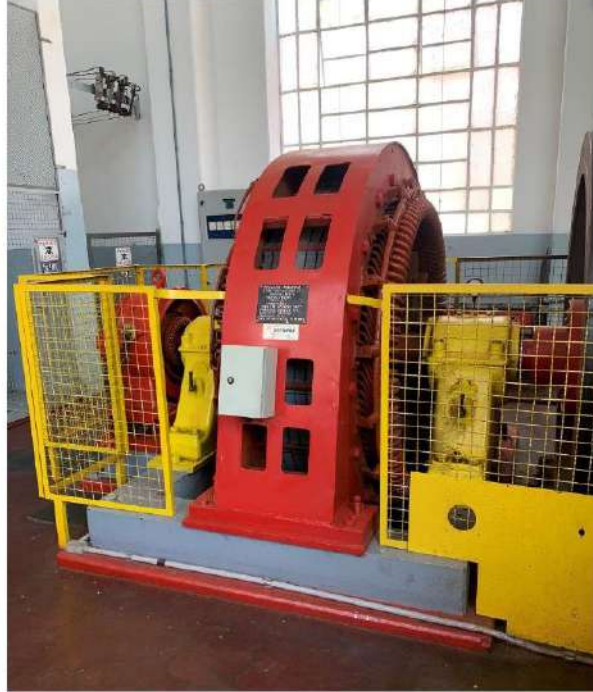
Foto 15 – Vista do Gerador.
