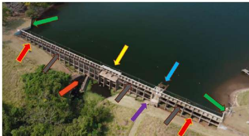
Foto 1 – Ilustra as estruturas do barramento: ombreiras (setas verdes), barragem MD e ME (setas vermelhas), trechos de vertedouro em soleira livre (setas cinzas), descarregador de fundo (seta laranja), vertedouro principal (seta amarela), vazão sanitária (seta roxa), tomada d'água (seta azul).
