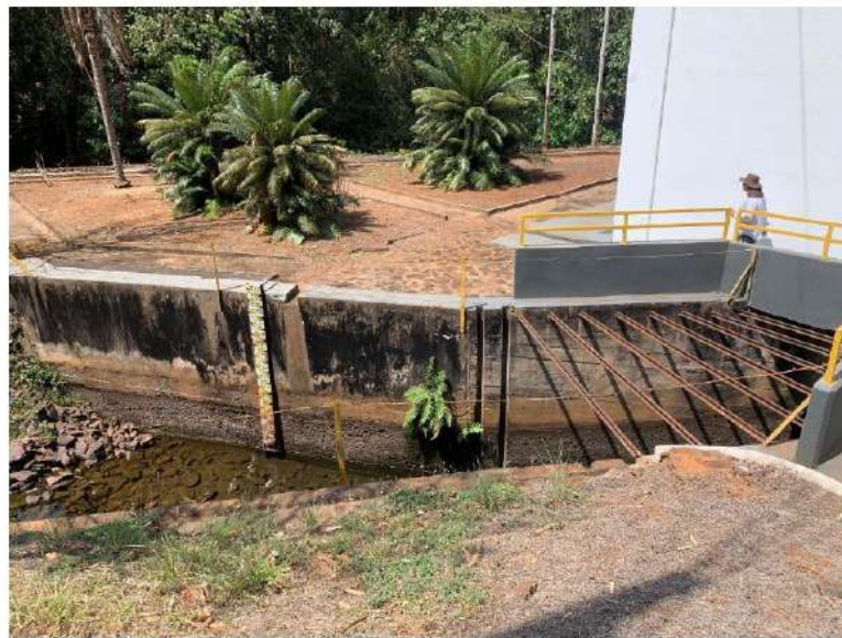
Foto 16 – Canal de Fuga e régua de controle do nível.
