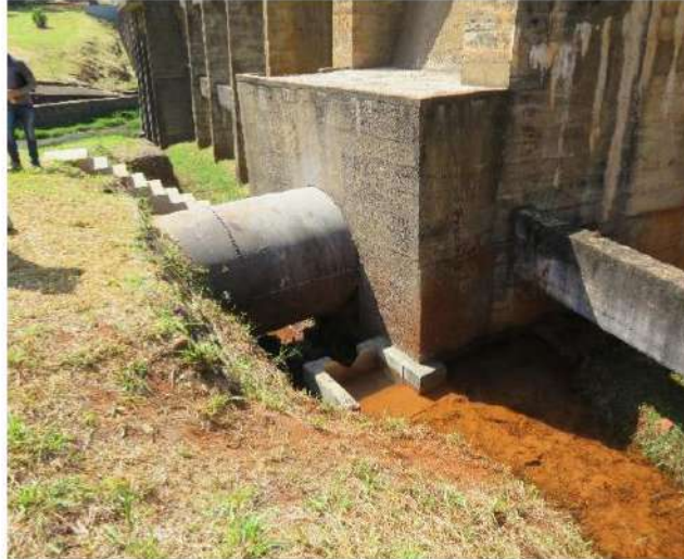
Foto 7 – Mostra o medidor de Vazão com vertedouro triangular junto a base do muro do conduto metálico.
